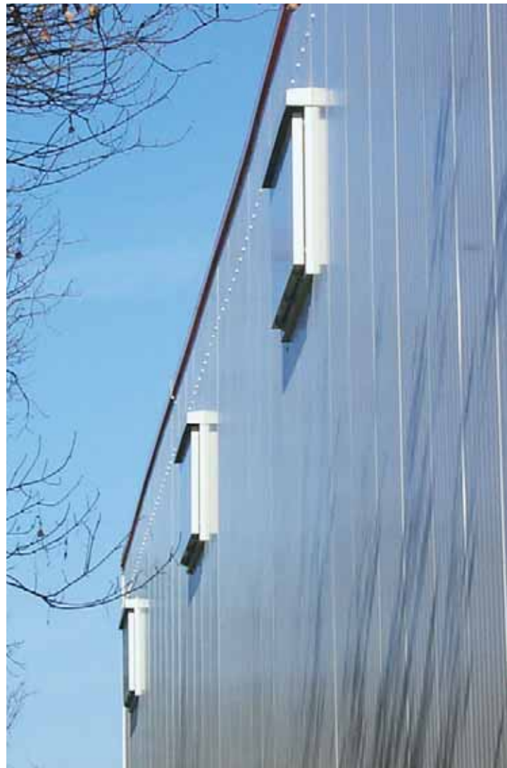
Bild: Anwendung von Kühlpaneelen
